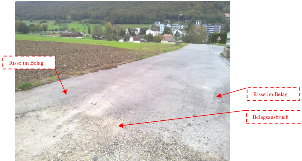
Belagsausbrüche beim Übergang zum Kies
